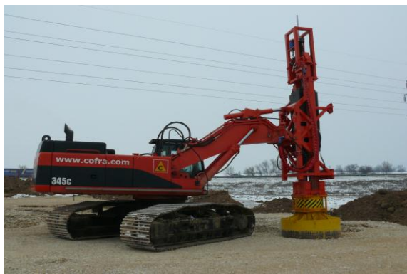
Obr. 7: Strojné vybavenie dynamického hutnenia
